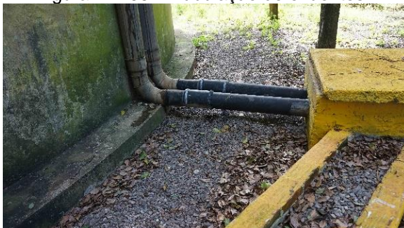
Figura IV-105 – Tubulação de efluentes
