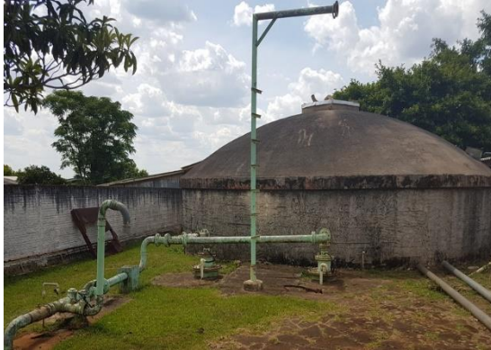
Figura IV-57 - Estação elevatória de água tratada EBAT - 02
