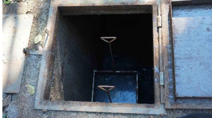
Figura IV-88 – Poço com cesto do tratamento preliminar
