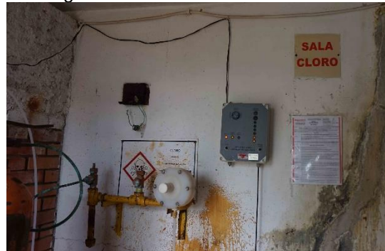
Figura IV-50 – Dosadores de cloro
