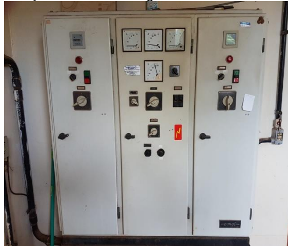
Figura IV-60 - Equipamentos elétricos da estação elevatória de água tratada EBAT - 05
