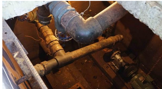
Figura IV-90 – Conjunto moto bomba instalado
