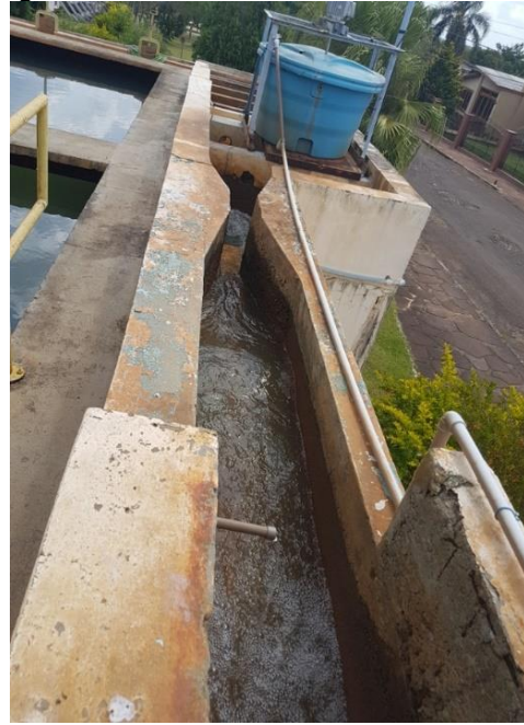
Figura IV-46 – Trecho inicial do tratamento
