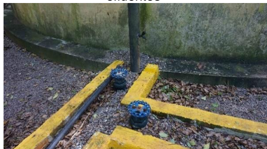
Figura IV-106 – Registros da tubulação de efluentes
