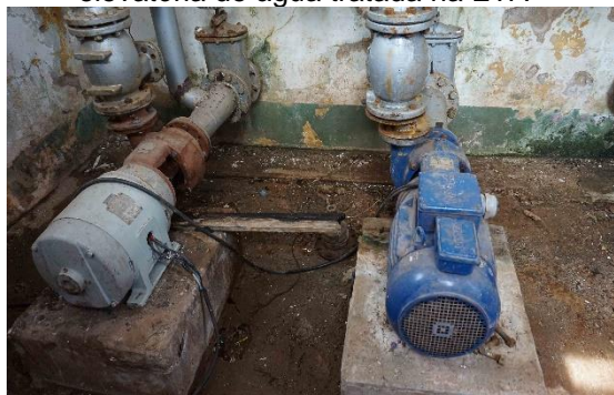
Figura IV-55 - Equipamentos da estação elevatória de água tratada na ETA
