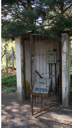
Figura IV-91 – Abrigo do quadro de comando
