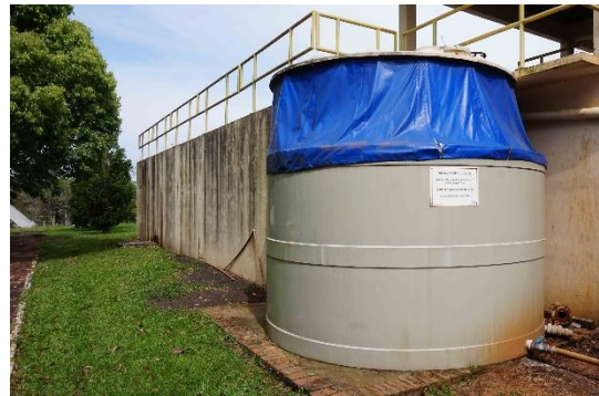
Figura IV-48 – Reservatório de sulfato de alumínio
