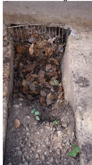
Figura IV-104 – folhas acumuladas num dos canais de drenagem do lodo
