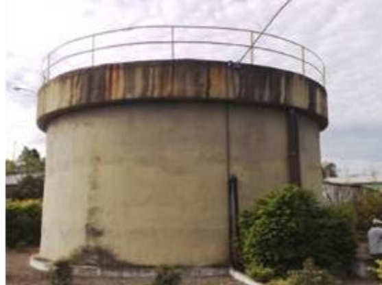
Figura IV-96 - Reator anaeróbico em concreto armado
