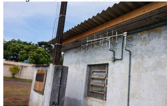
Figura IV-54 – Antenas de telemetria
