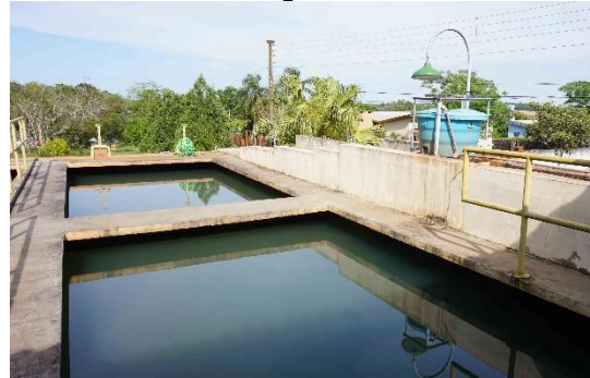
Figura IV-42 – Estação de Tratamento de Água
