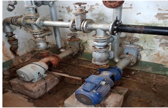
Figura IV-58 - Equipamentos de recalque da estação elevatória de água tratada EBAT - 03 e 04
