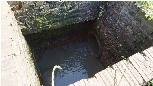
Figura IV-85 – Caixa de passagem das tubulações de entrada
