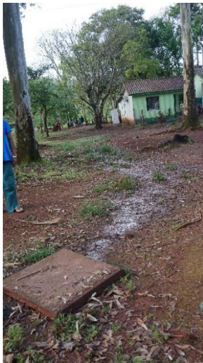
Figura IV-117 - Vista 03 do sumidouro transbordando
