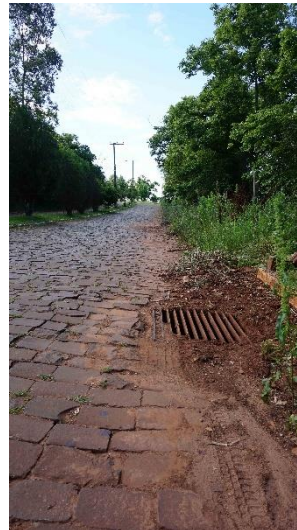
Figura IV-159 – Material acumulado junto ao bueiro
