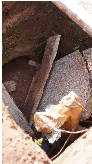
Figura IV-158 – PV obstruído dentro do cemitério
