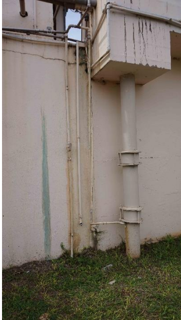
Figura IV-45 – Detalhe da tubulação de chegada a ETA
