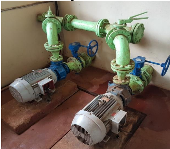
Figura IV-59 - Equipamentos da estação elevatória de água tratada EBAT - 05
