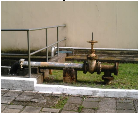
Figura IV-29 - Detalhe do sistema de captação de água bruta
