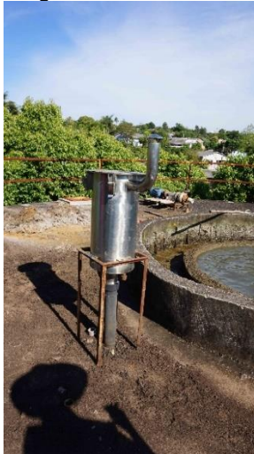
Figura IV-97 – Queimador dos gases gerados no reator
