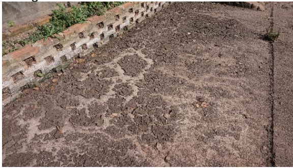
Figura IV-101 – Resto de lodo acumulado
