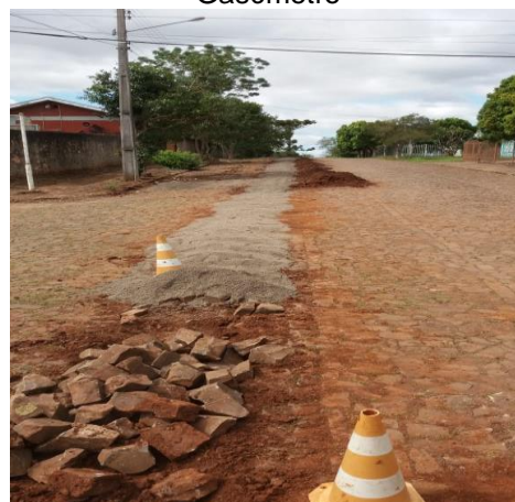
Figura IV-70 – Rede de distribuição de água substituída no Bairro CEEE Rua Usina do Gasômetro
