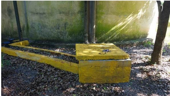
Figura IV-107 – Outra vista da tubulação de efluentes
