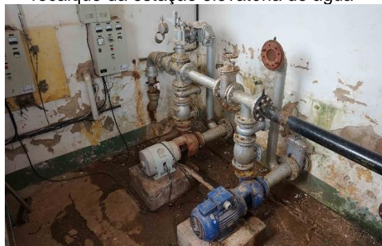
Figura IV-56 – Detalhe equipamentos de recalque da estação elevatória de água
