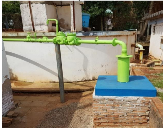
Figura IV-32 - Detalhe da captação de água bruta Poço SJA - 02
