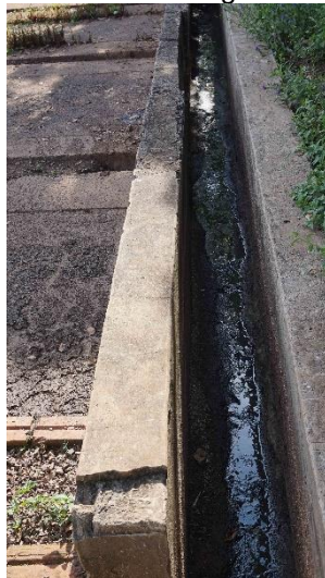
Figura IV-103 – Canal receptor do efluentes do leito de secagem
