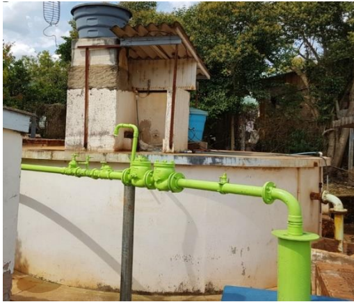
Figura IV-31 - Captação de água bruta Poço SJA - 02
