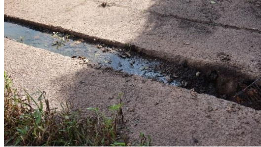
Figura IV-102 – Canal de drenagem do leito de secagem
