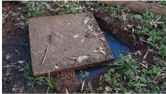
Figura IV-116 – Vista 02 do sumidouro transbordando
