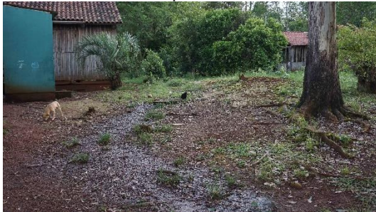
Figura IV-115 – Vista 01 do sumidouro transbordando e banheiro (verde) na esquerda
