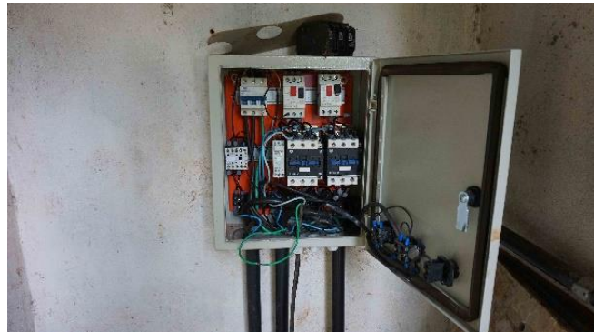
Figura IV-92 – Situação interna do quadro de comando
