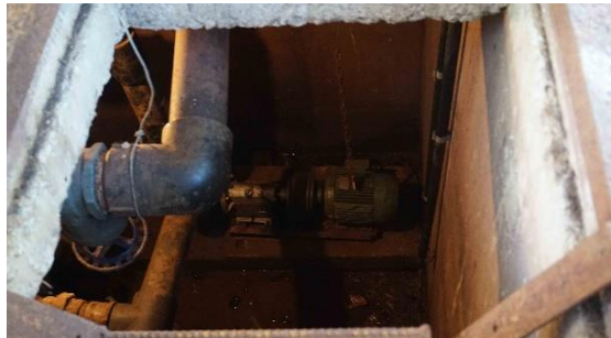
Figura IV-89 – Vista pela entrada do poço de bombeamento
