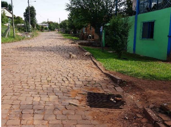
Figura IV-156 – Sistema de microdrenagem nas proximidades da ETE
